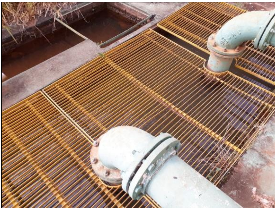
Figura 3.5 - Poço de sucção da estação elevatória situada na captação Ribeirão Barreiro. Coordenadas: Datum Sirgas 2000; 23S; 420410,170 E; 7526649,417 N.
