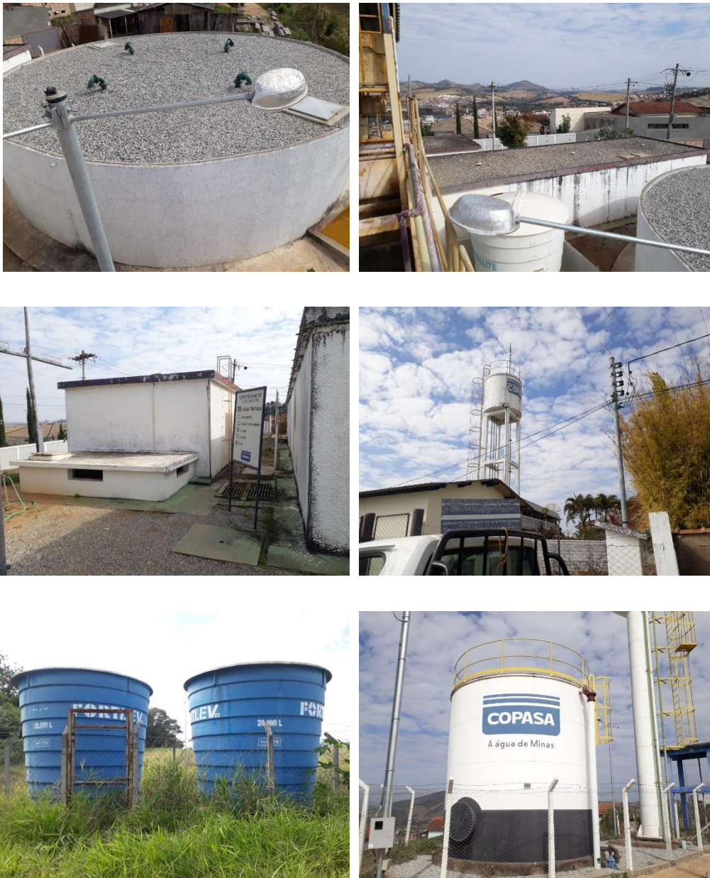
Figura 3.15 - Reservatórios de água do município de Cachoeira de Minas. Fonte: do autor.
