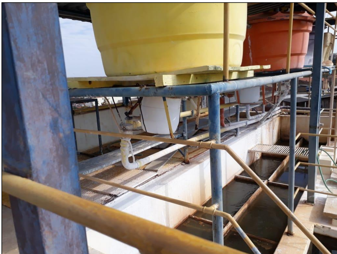
Figura 3.9 - Canal de chegada da água bruta e dosagem do coagulante e alcalinizante.
