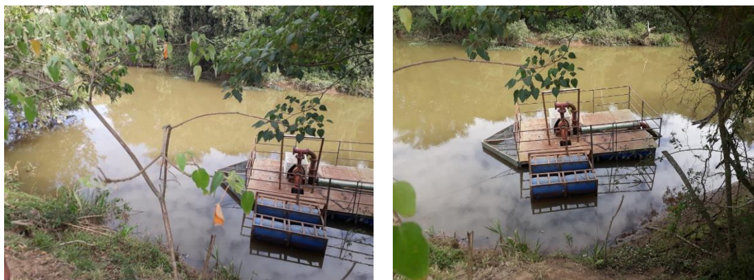
Figura 3.2 - Tomada de água no rio Sapucaí Mirim. Coordenadas: Datum Sirgas 2000; 23S; 419632,069 E; 7526394,274 N.
