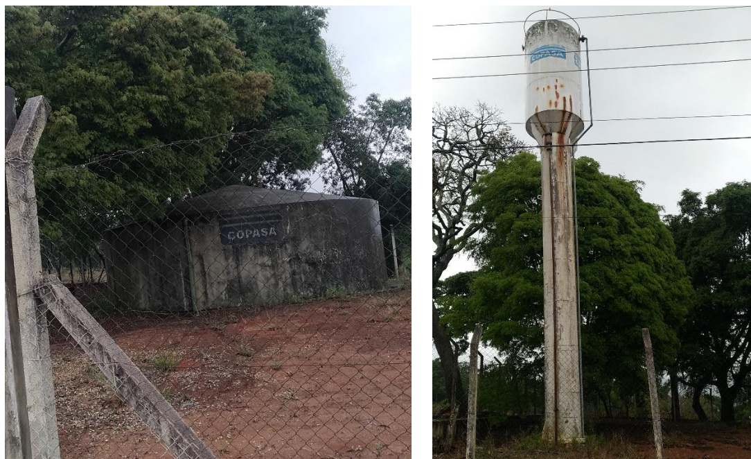
Figura 3.20 – Reservatórios de água do distrito de Itaim.
