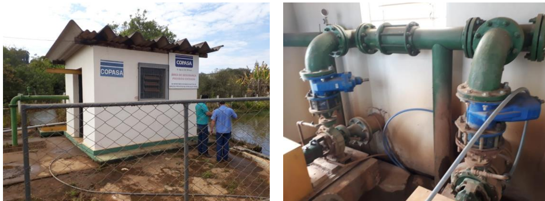
Figura 3.6 - Estação elevatória situada na captação Ribeirão Barreiro. Coordenadas: Datum Sirgas 2000; 23S; 420410,170 E; 7526649,417 N.
